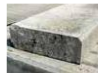
Παλιό σκυρόδεμα, σκυρόδεμα
